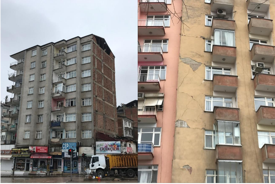
Şekil 7. Kalkan duvar ve bölme duvar hasarları (Elazığ, Merkez-Mustafapaşa Mah.)
